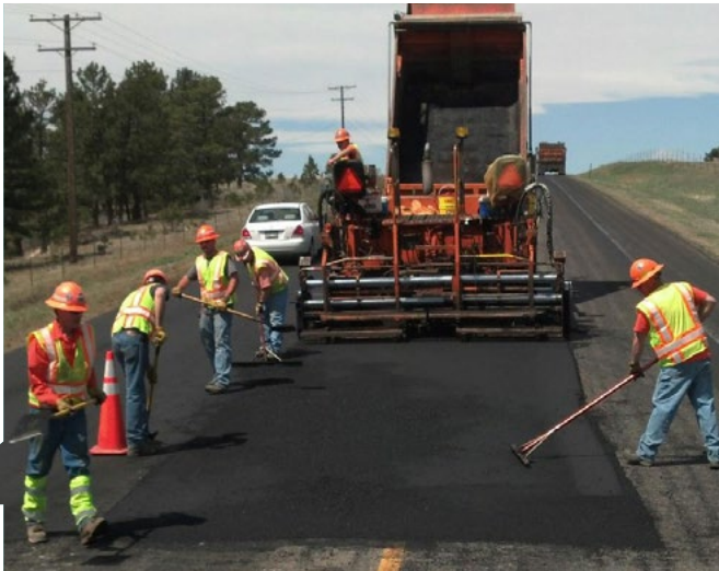
Cuadrilla de trabajadores en la pavimentación rural a lo largo de la Carretera Estatal 86 Fuente: CDOT, 2020
