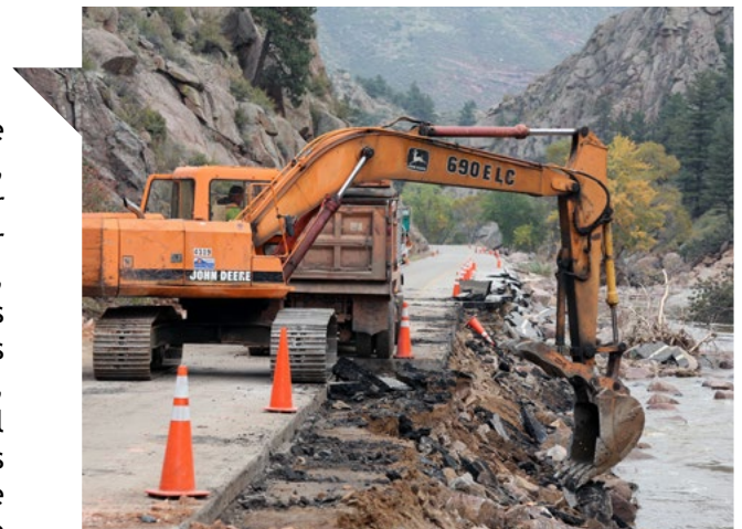
Cuadrilla de trabajadores empezando reparaciones luego de las inundaciones del 2013. Fuente: CDOT, 2020
