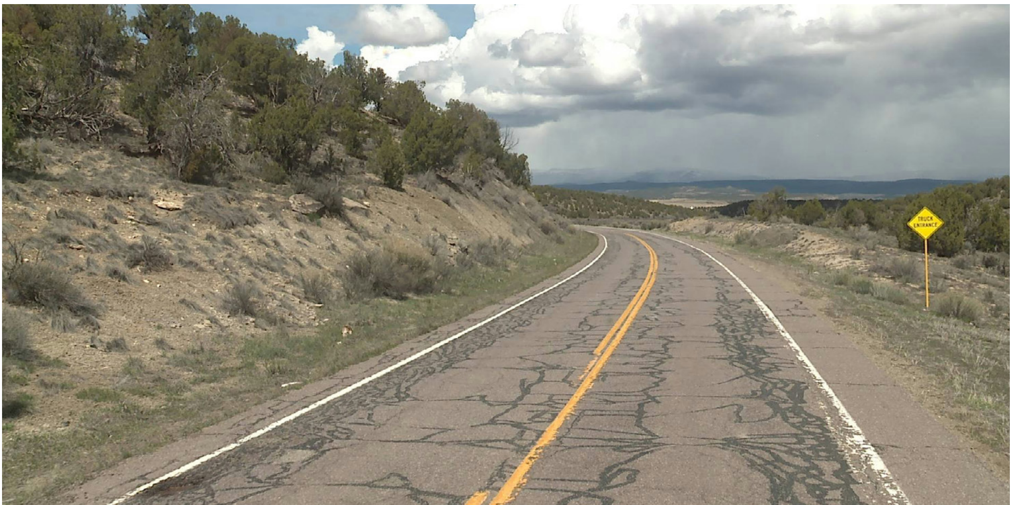
Pavimento en malas condiciones a lo largo de una autopista estatal rural
