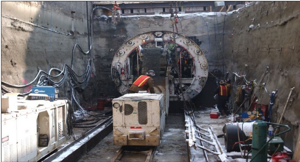
Tuberías de alcantarillado de la I 25 Sur. El Sistema de Central 70 no será exactamente igual, pero se construirá para soportar el tipo de tormentas que ocurren cada 100 años.
