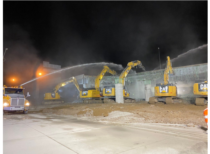
Camiones de agua durante la demolición del puente del bulevar Brighton, febrero de 2020
