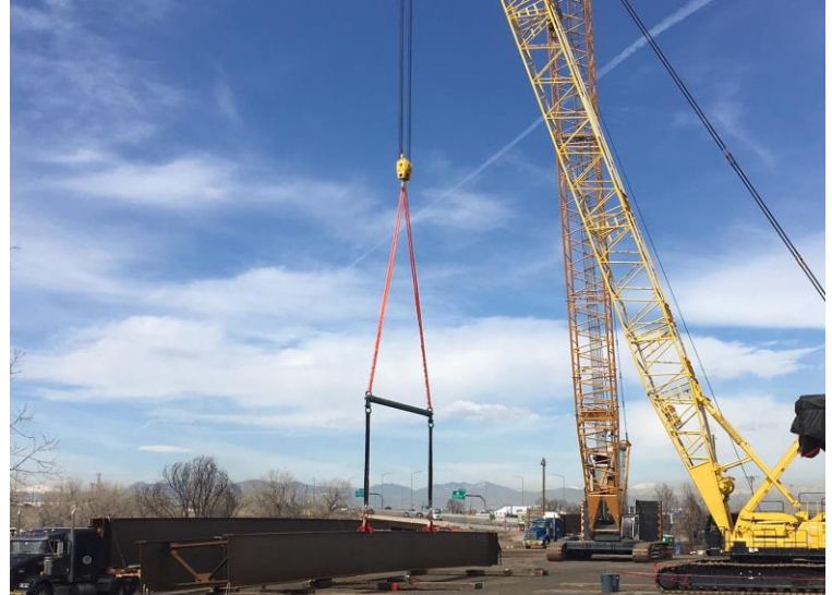
Se preparan a colocar las vigas del Puente elevado de la I-270
