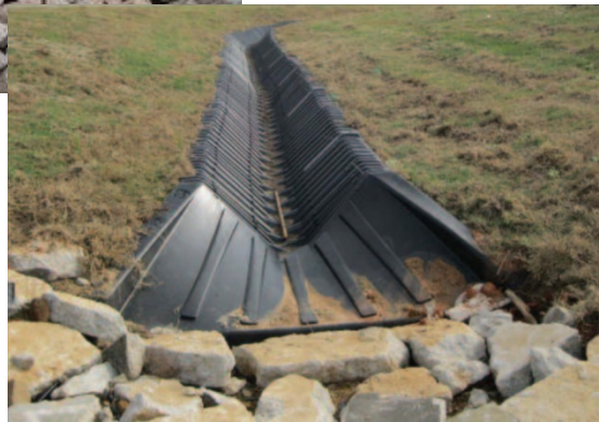
Source: UDFCD, Smart Ditch
