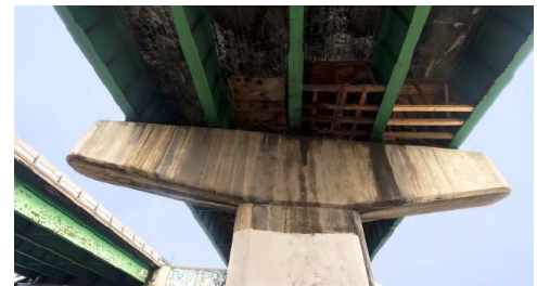
Deterioro de las condiciones del puente en la I-270 sobre Brighton Boulevard
